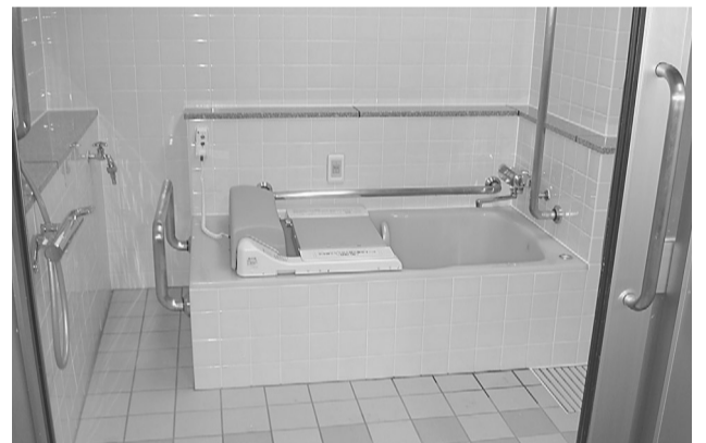
浴室 シャワー室
